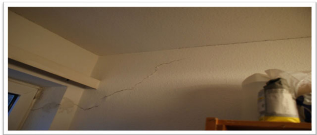
Rissbildung Haus 2, Raum 3
