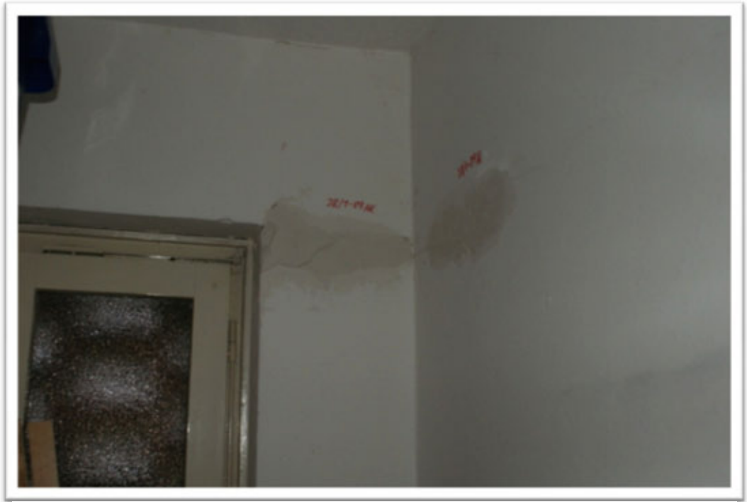
Rissbildung Haus 2, Raum 6
