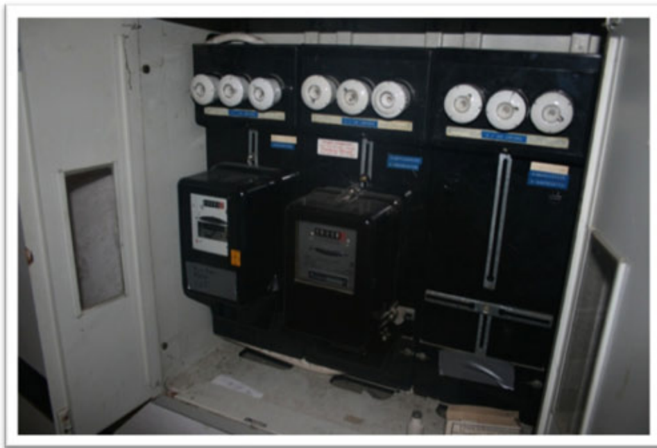
Zählerschrank mit Sicherungssockel
