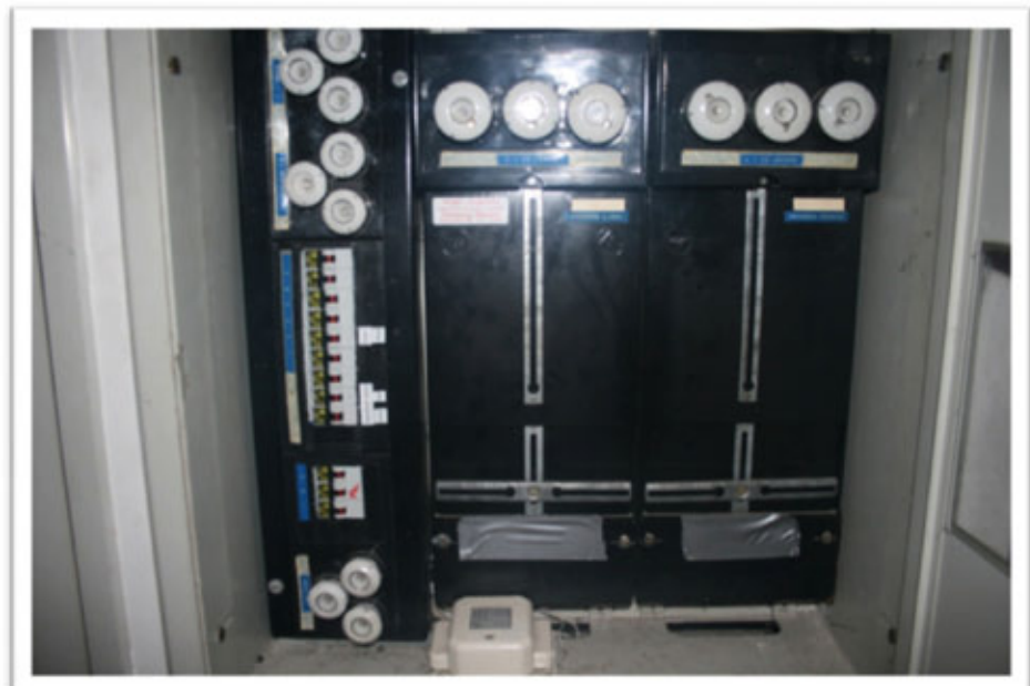
Zählerschrank mit Sicherungssockel
