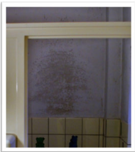
Schimmelbefall im Haus 1, Raum 10
