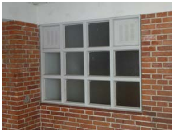
Steinzeugrahmen-fenster mit Einfachverglasung
