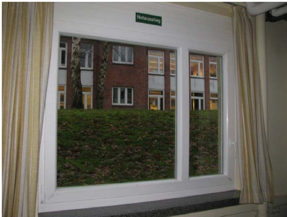
Abb. 17: Notausstiegsfenster des Werkraums 2 im KG des Hauptgebäudes
