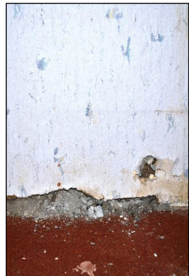
Abbildung 48 | Feuchtigkeitsschaden an der Innenwand des Raumes E1.09
