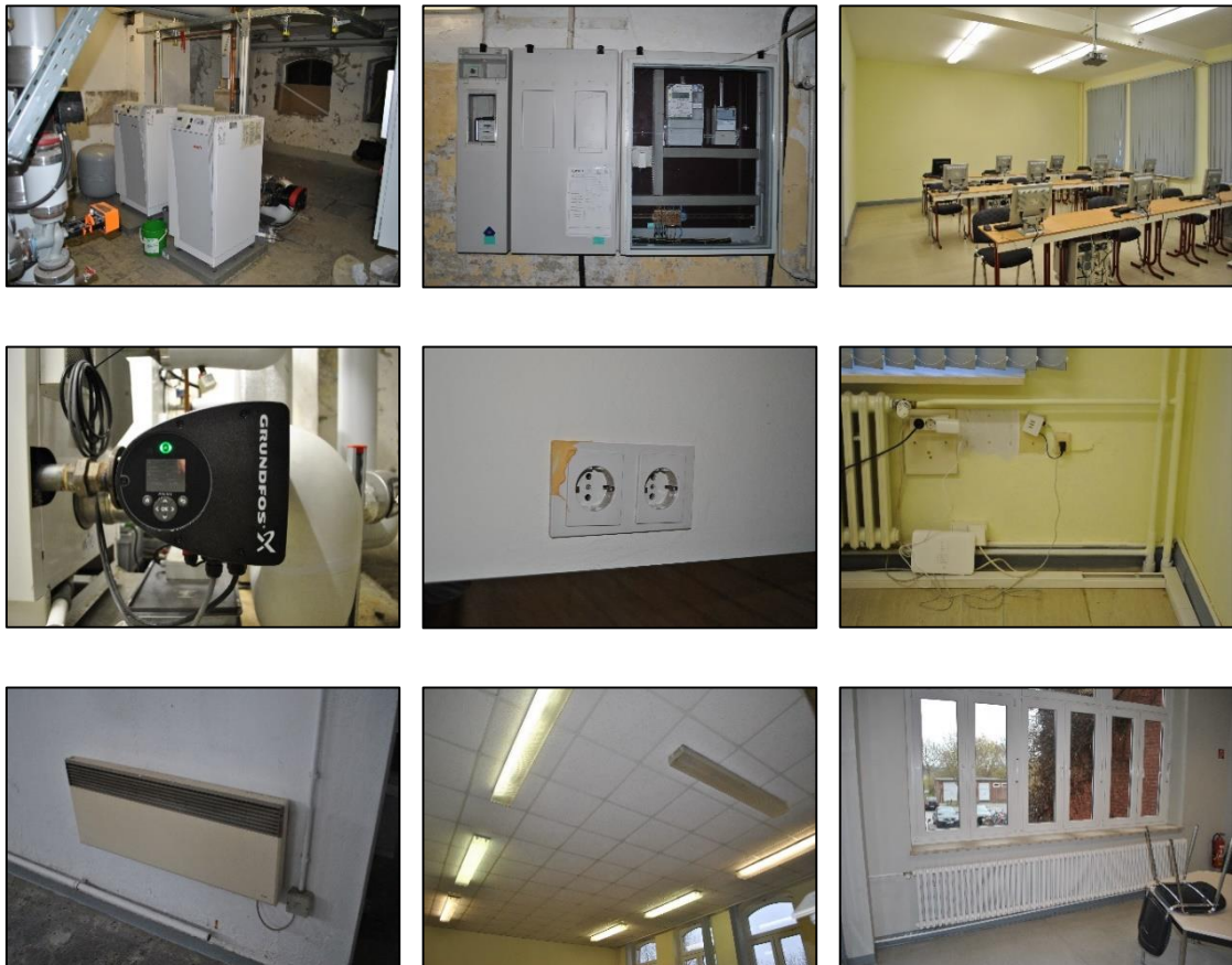
Abbildung 2 | Eindrücke der technischen Gebäudeausstattung
