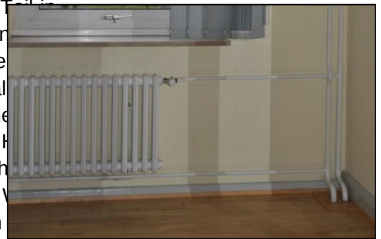
Abbildung 12 | Gussradiator im guten Zustand
