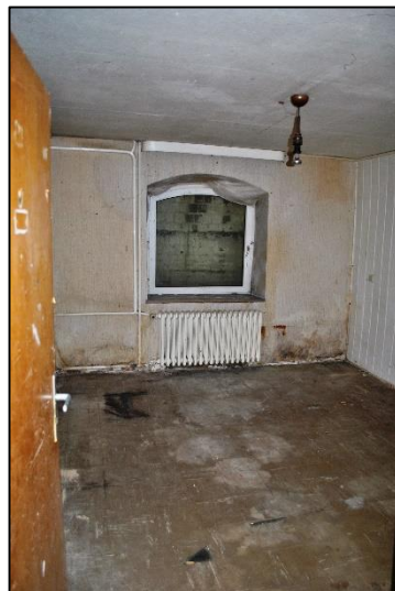
Abbildung 47 | Feuchte geschädigter Raum der Einliegerwohnung
