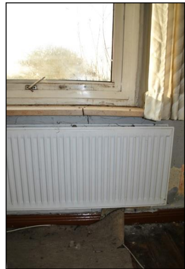
Abbildung 45 | Setzrisse im Fensterbereich Raum E1.05
