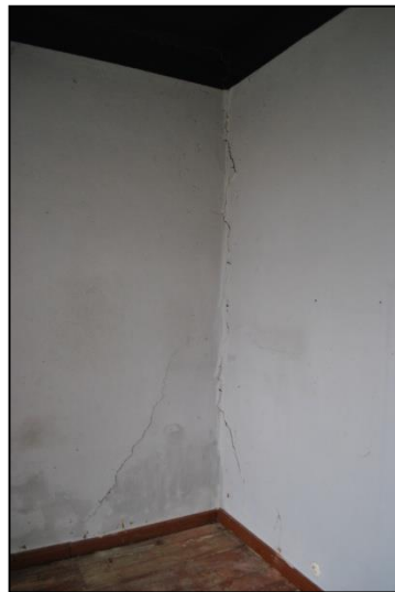
Abbildung 44 | Setzrisse im Mauerwerk Raum E1.05
